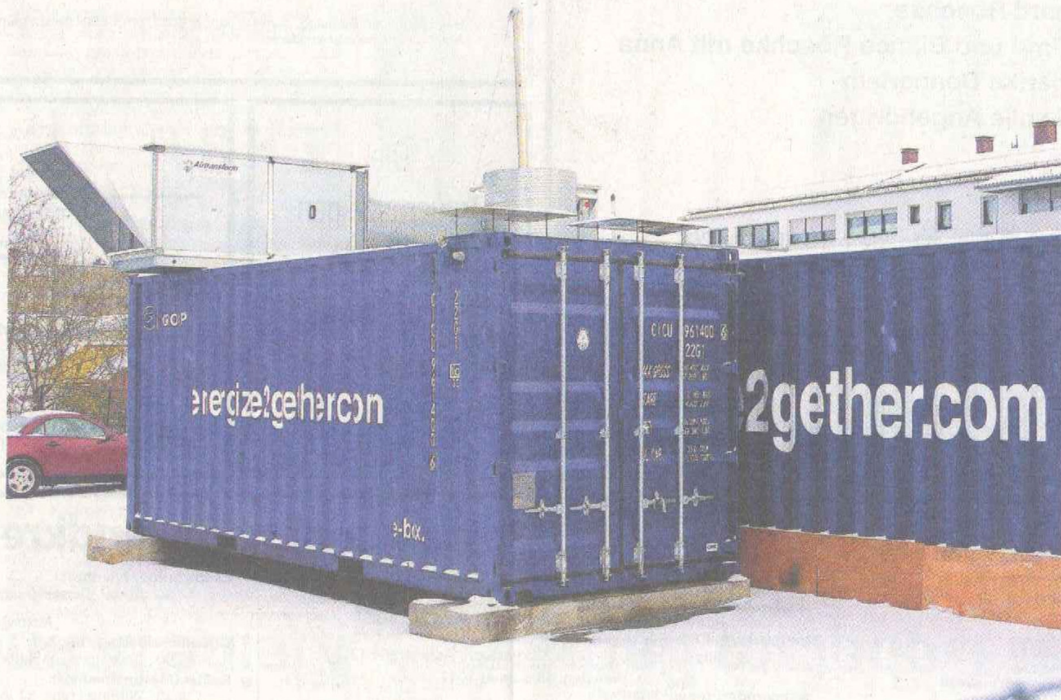
GFE-Container in Poppenreuth: Auf dem Parkplatz des Gewerbegrundstücks fallen die sogenannten Blockheizkraftwerke des Nürnberger Unternehmens nicht besonders auf.
